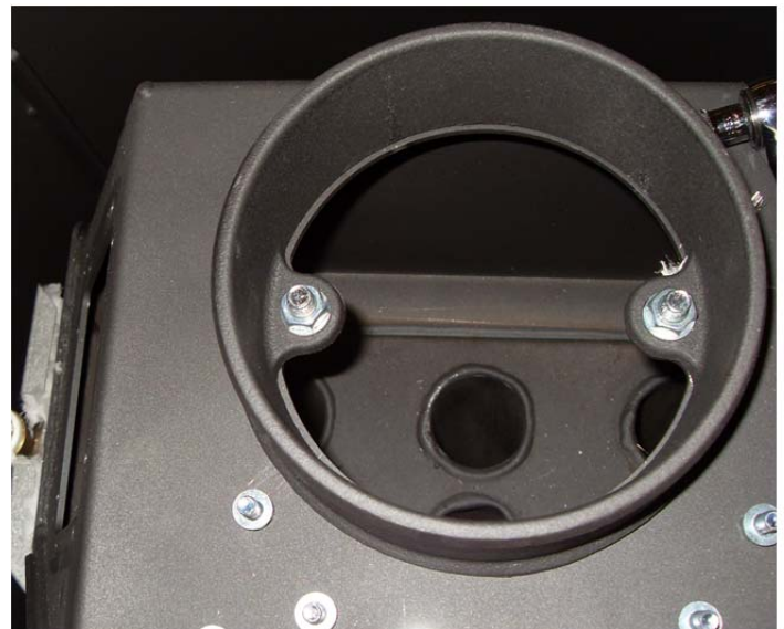
Reinigung durch den oberen Rauchrohranschluss
